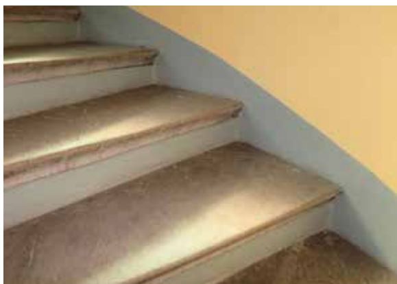
Trappstegen är klädda med tjock hållbar skiva av kalksten. En målad skursockel följer trapploppets stigning.
